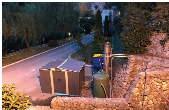
Slika 3: Pilot postrojenje na bazi pješčane filtracije na lokaciji izvorišta Jadro
