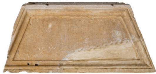
8. Znatno oštećene profilacije na elementu B5 (fototeka HRZ-a, snimio J. Kliska, 2019.) Significantly damaged mouldings on element B5 (HRZ Photo Archive; J. Kliska, 2019)
