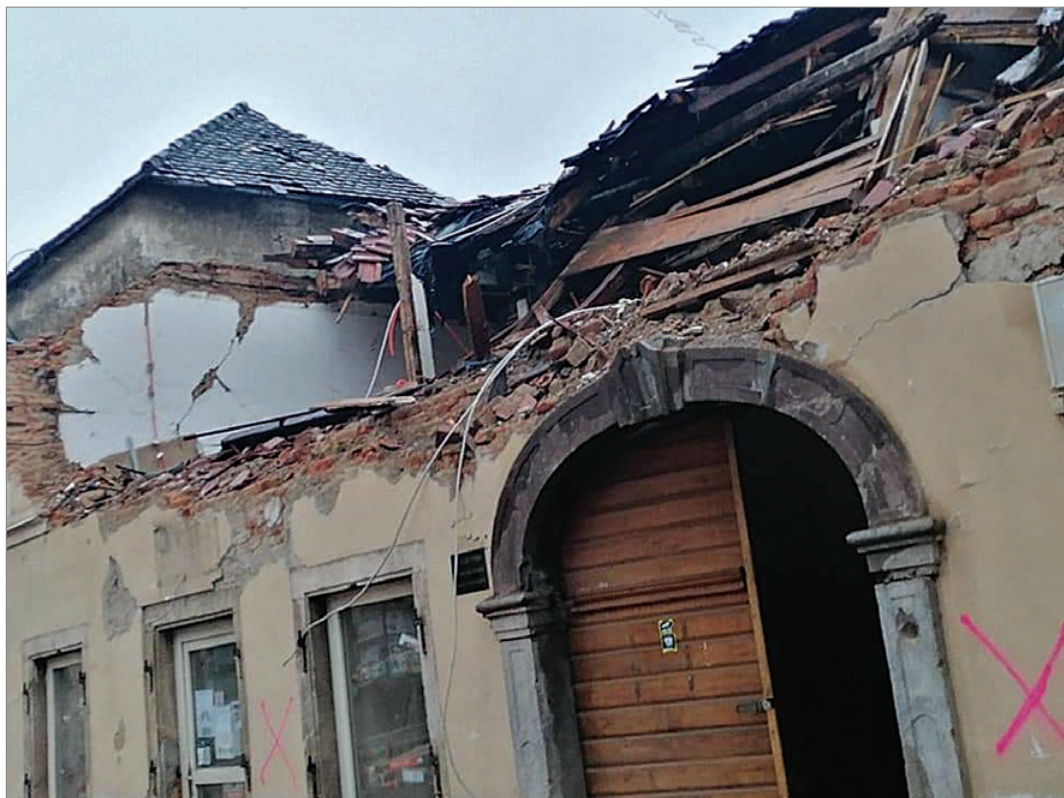
Sl. 7. Građevina oštećena potresom u užem centru Petrinje foto: Davorka Sokač
