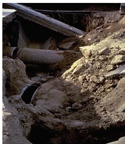
Slika 13 Cjevovodi stradali uslijed likvefakcije u potresu M6.5 San Fernando 9.02.1971. Za fotografiju zahvaljujemo National Information Service for Earthquake Engineering University of California Berkeley
