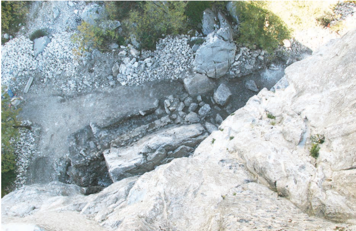
SLIKA 16. Pogled na sondu 4; temelj južnog zida moguće obrambene kule, 2013. (foto: N. Topić, Omega engineering d.o.o. Dubrovnik).
