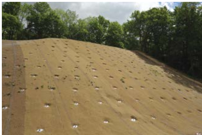
Slika 13. Nestabilni stjenoviti pokos jednolikog profila uz koju geoletivo za zaštitu od erozije dobro prijanja
