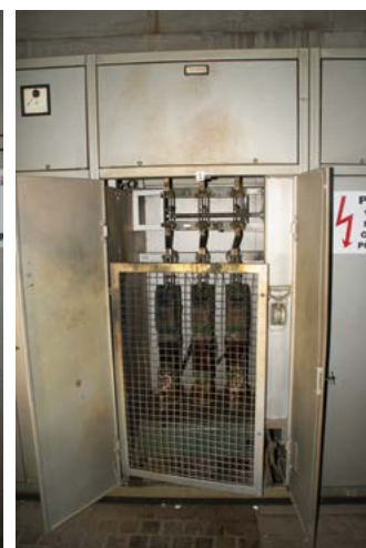
Slika 2. Tragovi na rasklopnjoj opremi [4]
