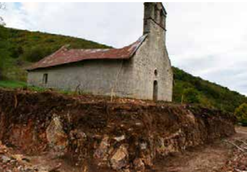
Sl. 3. Sv. Ivan, 13. 10. 2015., pogled sa sjeverozapada (foto: T. Kolak) Fig. 3 St. John, 13/10/2015, view from the north-west (photo:T. Kolak)
