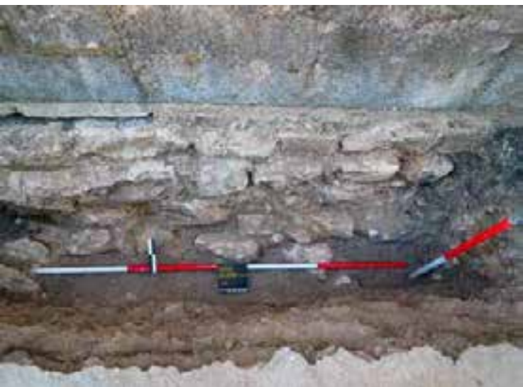
Sl. 9. Temeljna stopa zida crkve iz 14. - 15. st. uz južni vanjski zid crkve sv. Luke iz 18. st.
