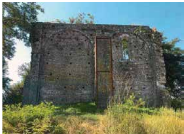
Sl. 33a-b. Pogled na sačuvani dio crkve sa sjevera (ispis slike iz snimke Terenca Pepe)
