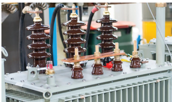
Slika 7 Priključci transformatora unutar vakuumske komore Figure 7 Transformers terminals in vacuum chamber
