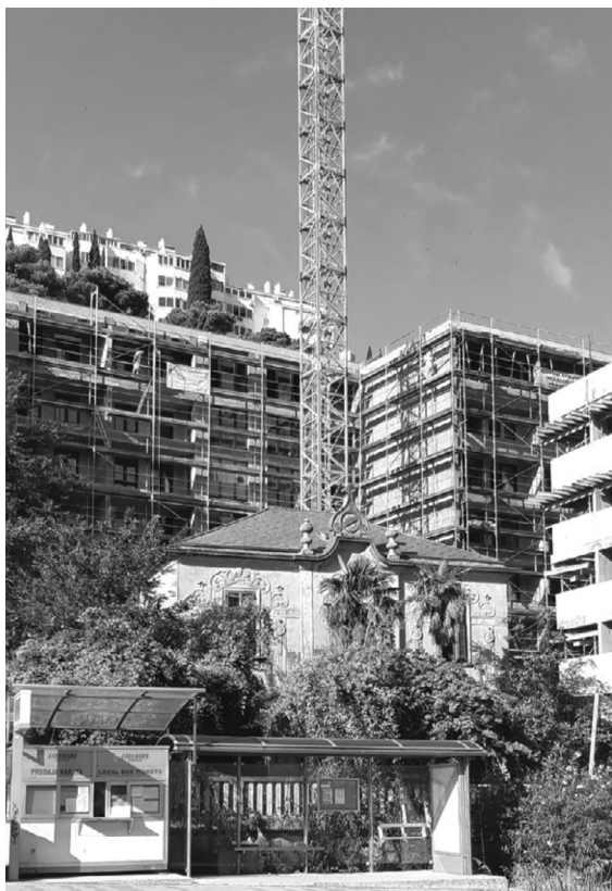
KAOTIČNI SUDAR ARHITEKTONSKIH TIPOLOGIJA, ODSUSTVO MEHANIZAMA OČUVANJA BAŠTINE I ODSUSTVO MJERILA I MJERE, 2020.; FOTO: ROMANO DUIĆ
