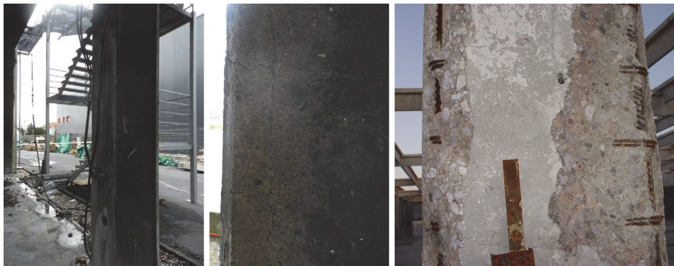
Slika 5. Oštećenosti stupa uslijed požara: a) zacrtnjen stup; b) pukotine; c) vidljiva armatura
