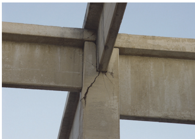
Slika 7. Oštećenje detalja na mjestu spoja greda - stup
