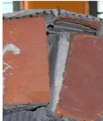
Slika 4. Stvaranje pukotine sa središtem rotacije u donjem dijelu pukotine, fotografija Ł. Bednarz
