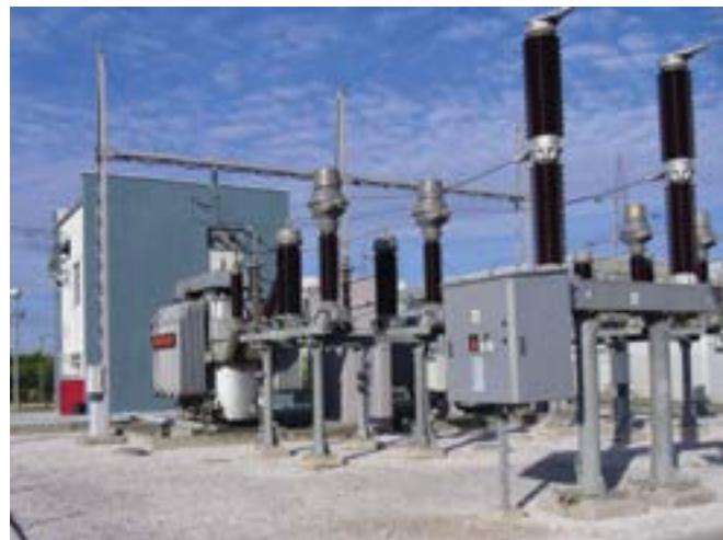
Slika 6. Prekidač tip 7F1-II u EVP-u 110/25 kV Opuzen
