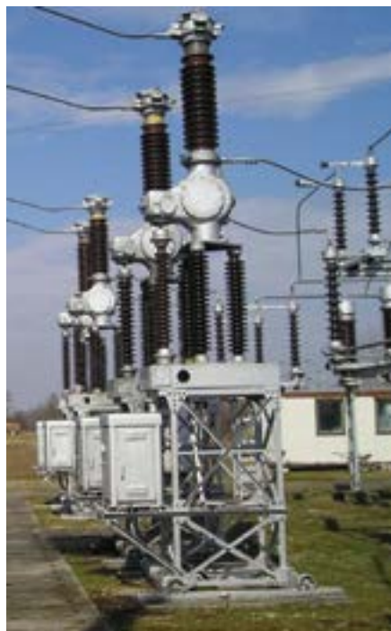
Slika 2. Malouljni prekidač 110 kV u EVP-u 110/25 kV Ludina
