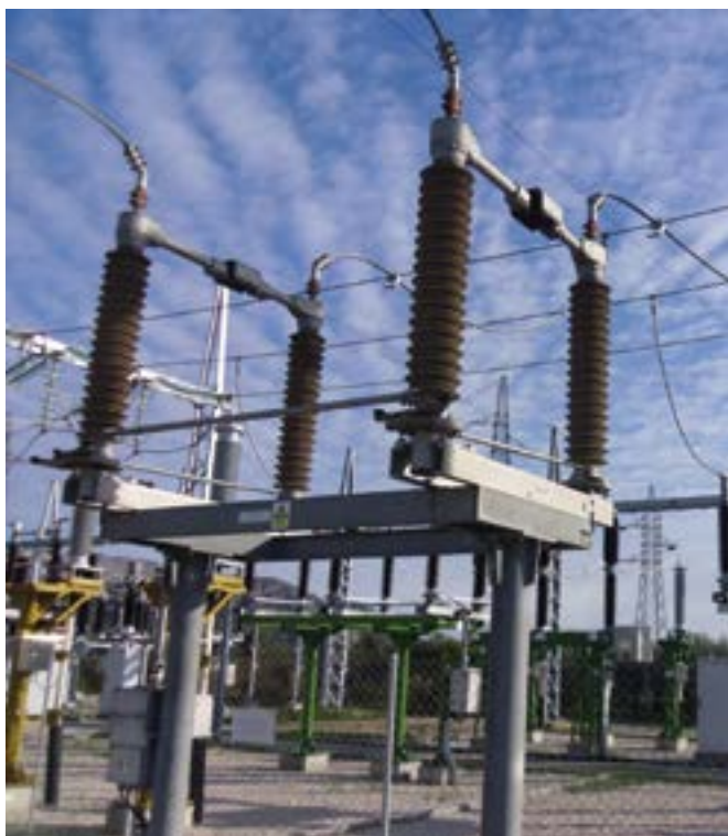
Slika 8. Rastavljač tipa CB 123-II-8 u EVP-u 110/25 kV Opuzen
