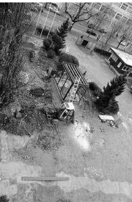
sl.3. Početak radova bušenja u dvorištu muzeja radi realizacije geotermalne dizalice topline
