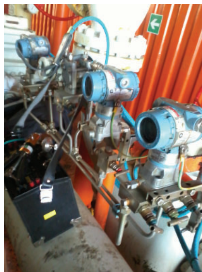
Slika 7. Diferencijalni transmiter tlaka instaliran na platformi Ivana A
