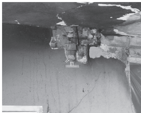
Slika 4. Mjesto gdje se nalazilo brojilo električne energije s osiguračima Figure 4. Location of the electric meter with fuses
