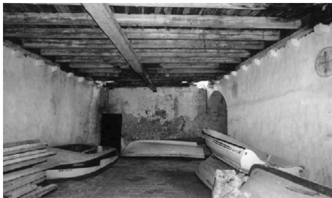
FRANJEVAČKI SAMOSTAN I UTVRDA GOSPE OD ŠPILICA NA LOPUDU, ZATEČENO STANJE; IZVOR: ARCUS DALMATIA
