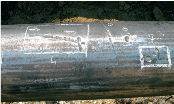
Slika 2. Pojedinačna korozijska oštećenja vanjskog dijela plinovoda
