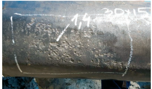
Slika 3. Primjer „klaster“ korozije
