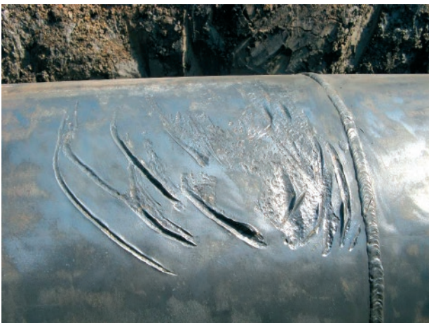
Slika 4. Mehaničko oštećenje nastalo radnim strojem za melioraciju
