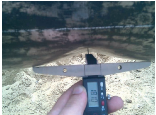
Slika 5. Deformacijsko oštećenje cijevi plinovoda (udubljenje ili engl. „dent“)
