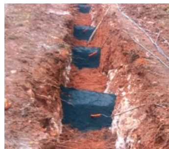
Slika 10. Horizontalno anodno ležište
