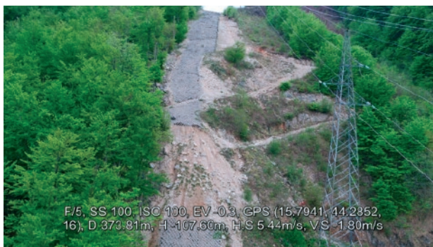
Slika 20. Erozijski odron terena
