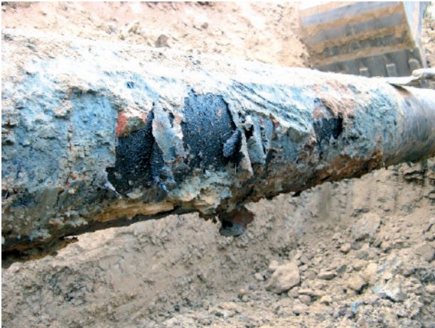
Slika 17. Primjeri loše antikoroziivne prevlake
