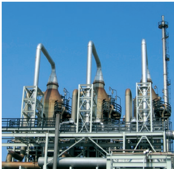
Slika 13. Lo-cat postrojenje za odsumporavanje na Molvama
