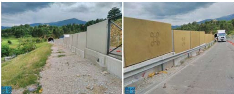
SI 10: Konačan izgled izvedenih zidova za zaštitu od buke tipa RUCONBAR na obilaznici Bitole
