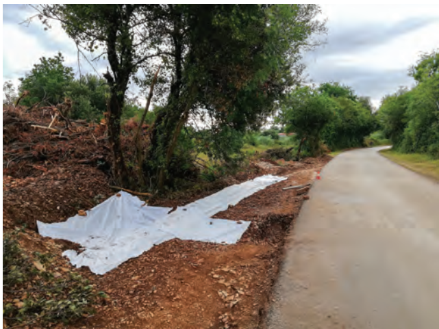
Sl. 19 Prekrivanje geotekstilom područje otkrivenog nabijenog austrougarskog puta s rubnjacima od fino lomljenog kamena (fotografija: R. Zlatunić).
