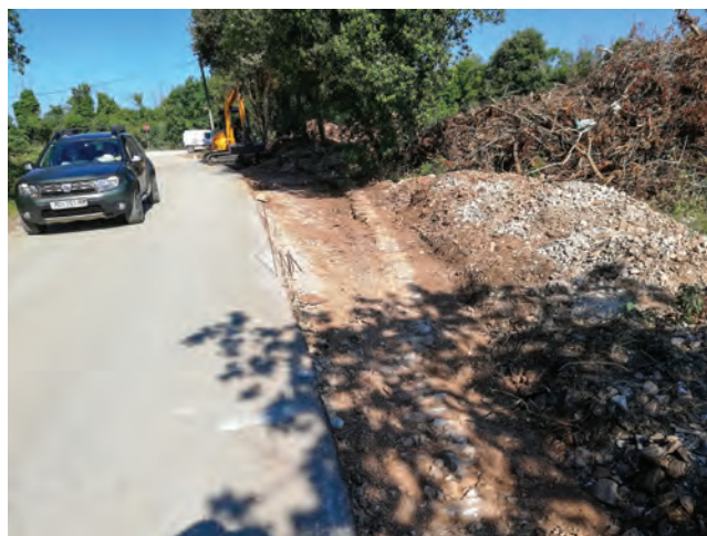
Sl. 14 Pogled na veći dio iskopane trase, gdje je otkriven austrougarski put s očuvanim rubnicima od finog lomljenog kamena (fotografija: R. Zlatunić).
