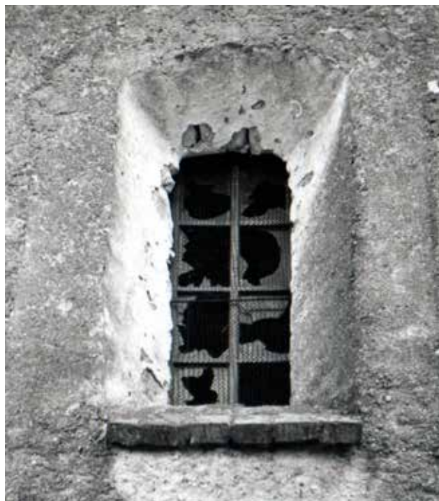
12 Martin, crkva sv. Martina, barokni prozor formiran na poziciji nekadašnjega ulaznog otvora na zapadnom pročelju crkve – stanje prije obnove crkve 1977. (foto: D. Majer 1977.)
