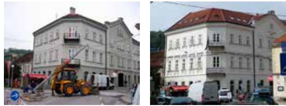
16, 17 Krapina, Zgrada Županije, pogled na pročelje prije radova 2015. i nakon radova 2015. (fototeka KOKR). Vrsta boje, proizvođač: silikatna, Caparol. Godina obnove: 2015.
