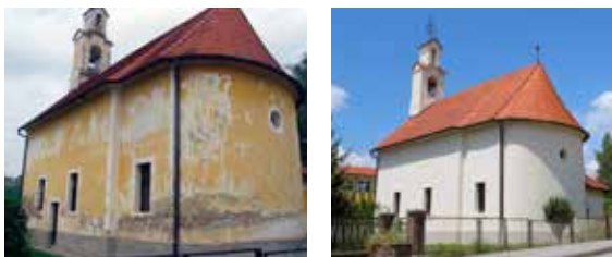
36, 37 Desinić, Kapela sv. Ane, pogled na začelje prije obnove 2009. i nakon obnove 2019. (fototeka KOKR). Vrsta boje, proizvođač: silikatna, Caparol. Godina obnove: 2018.
