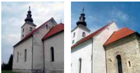
9, 10 Konjščina, Župna crkva sv. Dominika, pogled na crkvu prije radova 2009. i pogled na obnovljeno pročelje lađe i otučeno pročelje svetišta s nalazom gotičkih otvora 2014. (fototeka KOKR)
