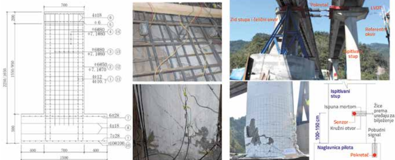
Slika 2. Primjena pametnih agregata u otkrivanju oštećenja: lijevo: praćenje stanja AB posmičnih zidova [30], desno: praćenje stanja na mostu Niu-Dou na Tajvanu [28]
