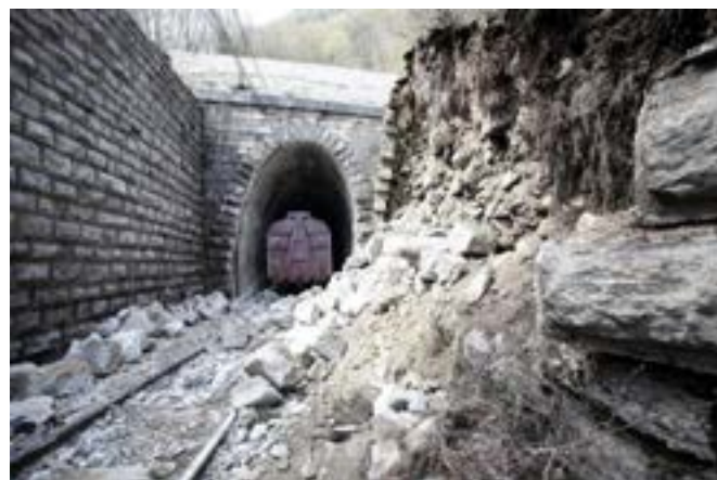
Slika 3. Odron potpornog zida kod tunela Kupjak
