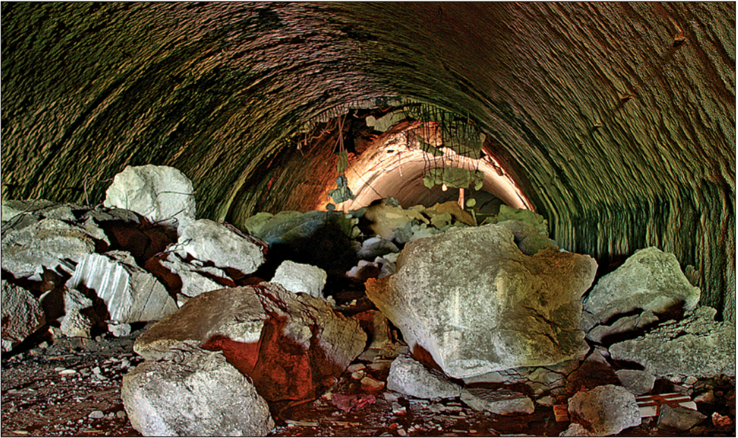
U tunelu 4 vidljiva je snaga eksplozije koja je urušila dio armiranobetonske cijevi tunela i otvorila unutrašnjost planine
