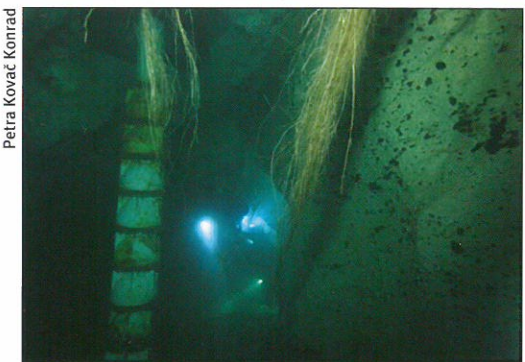
Slika 4. Pumpe na ulaznom dijelu izvora
