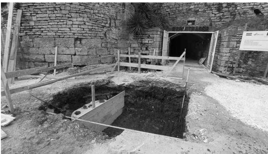
Sl. 6. Zaštita dijela otkrivenih struktura radi izvođenja radova uz poligonalnu kulu (snimila Kristina Gergeta Sotončić)
