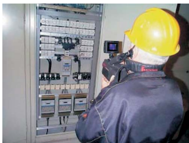
Figure 6 Using a hand held thermovision camera on board ship Slika 6 Uporaba ručne termovizijske kamere na razvodnoj ploči broda
