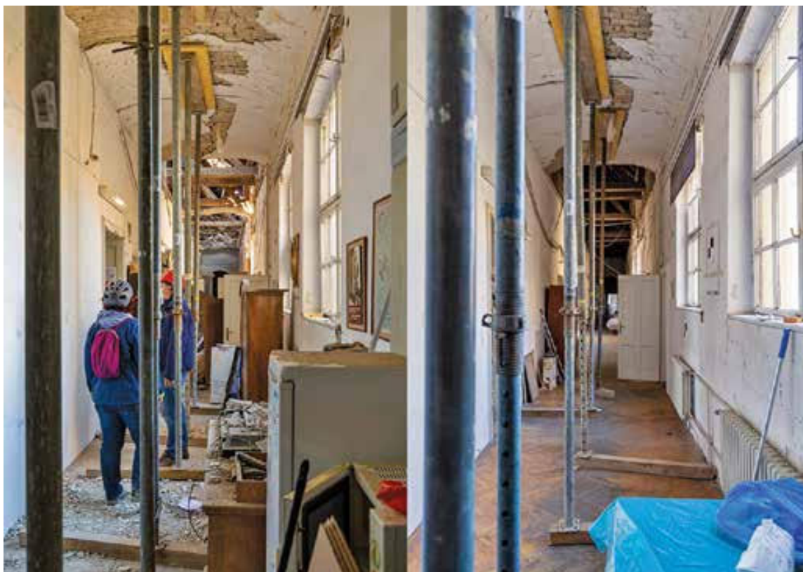
Slika 3. Štete od potresa na zgradi Muzeja za umjetnost i obrt, neposredno nakon potresa 22. ožujka 2020. godine (lijevo) i šest mjeseci poslije (desno). Fotografirao Denis Bučar, Fototeka MDC-a.
