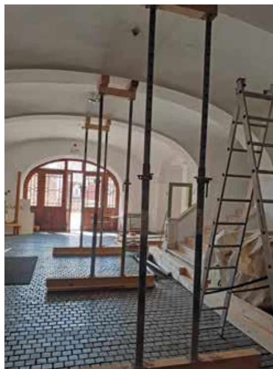
Slika 3. Podupirači u veži palače Vojković-Oršić-Kulmer-Rauch postavljeni radi stabilizacije oštećenog svoda velike dvorane na katu. Fotografirala Matea Brstilo Rešetar.
