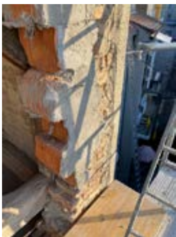
Slika 14 Spoj postojećeg zabatnog zida i istočnog tavanškog nadozida sa vidljivom degradacijom materijala
