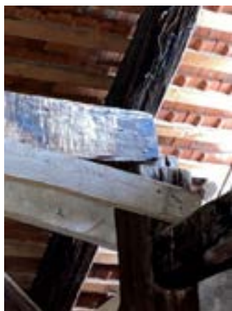
Slika 3 Ispadanje podrožnice iz ležišta – Stambena zgrada Medulićeva 17
