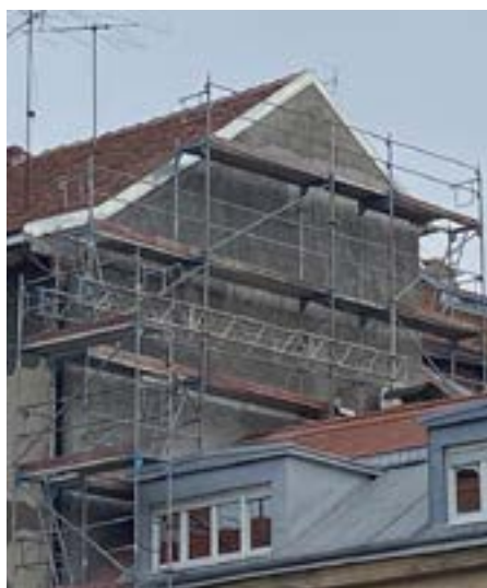
Slika 16 Prikaz saniranog zabatnog zida
