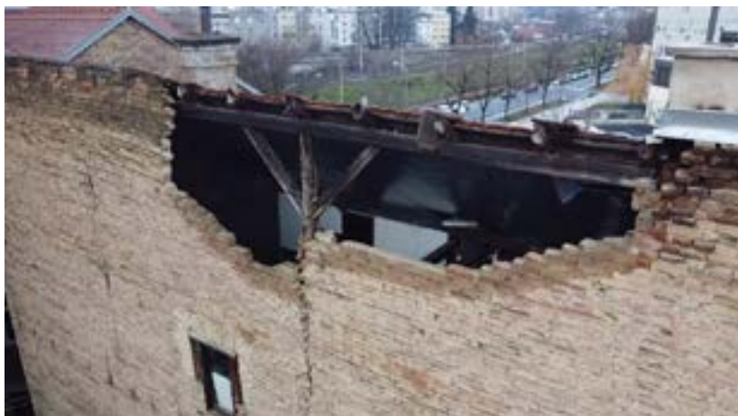
Slika 5 Postojeće stanje tavanskog zida objekta Pierottijeva 11
