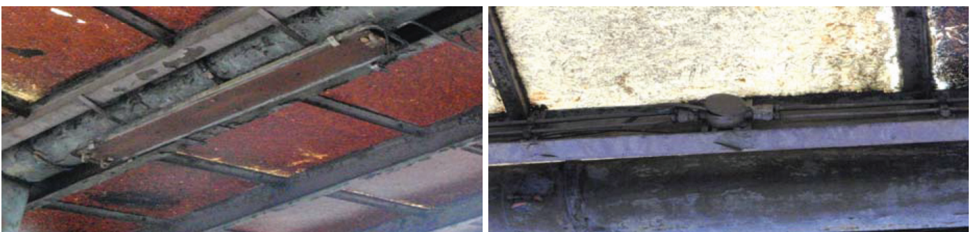
Slike 6. i 7. Stanje nadstrešnica
