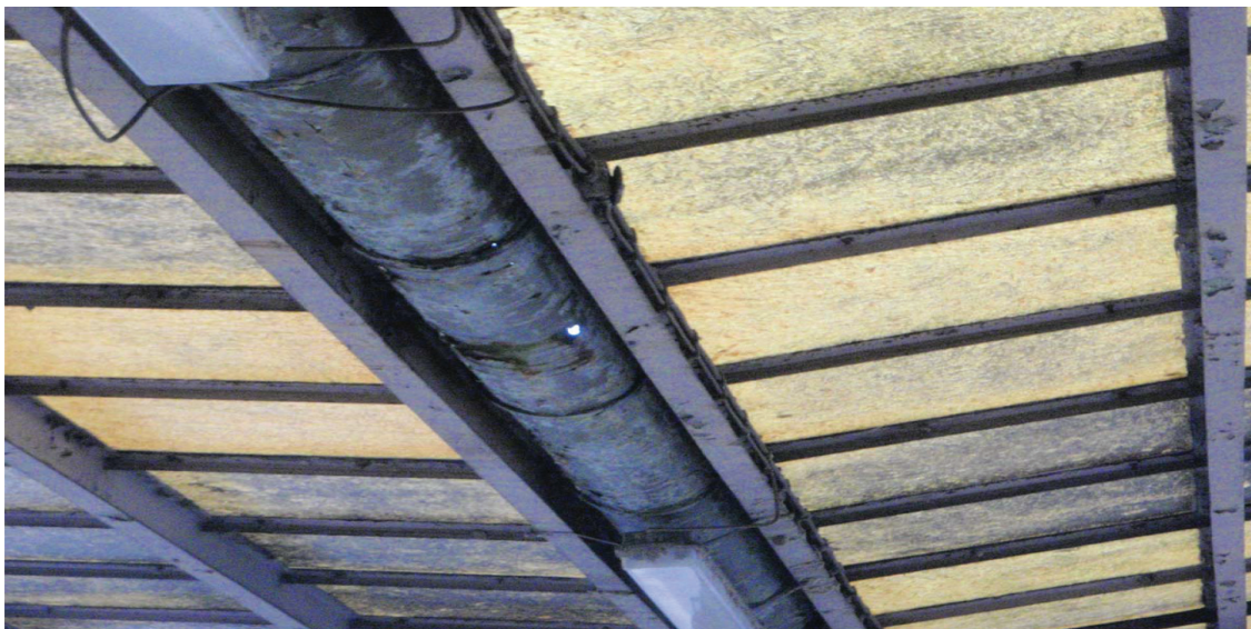
Slika 2. Istrošenost sabirnoga oborinskog kanala na nadstrešnici
