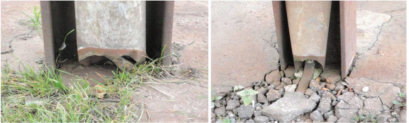
Slike 4. i 5. Pražnjenje oborinskih oluka (na slici 5. vidljivo je da čak i traka uzemljenja prolazi kroz oluk i pod kutom ulazi u peron
