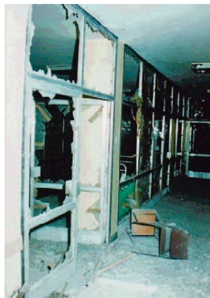
SLIKA 1. RAZARANJA ODJELA OPĆE BOLNICE KARLOVAC TIJEKOM DOMOVINSKOG RATA
