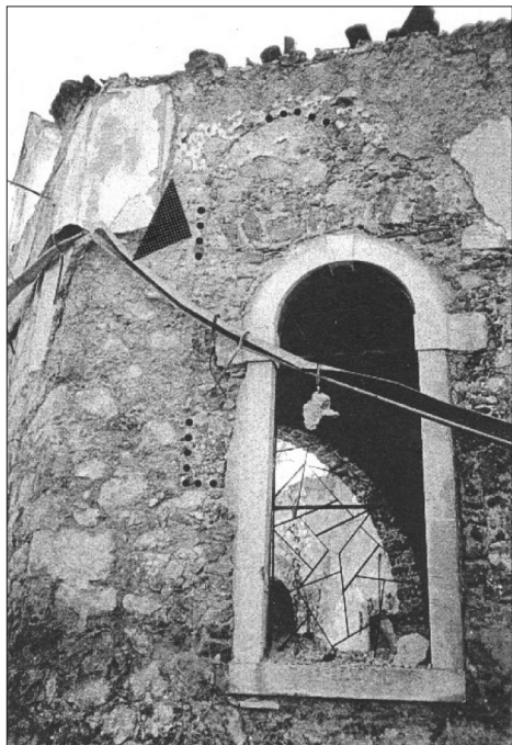
Sl. 6. Slunj, župna crkva Presvetog Trojstva, zazidani prozor iz 16. st. na južnom zidu svetišta: točkasto označen obris srednjovjekovnog prozora (foto: T. Petinec, 1995)
