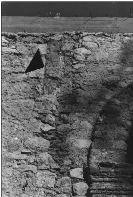
Sl. 7. Slunj, župna crkva Presvetog Trojstva, trag otklesane službe gotičkog svoda svetišta (foto: Z. Horvat, 1997)
