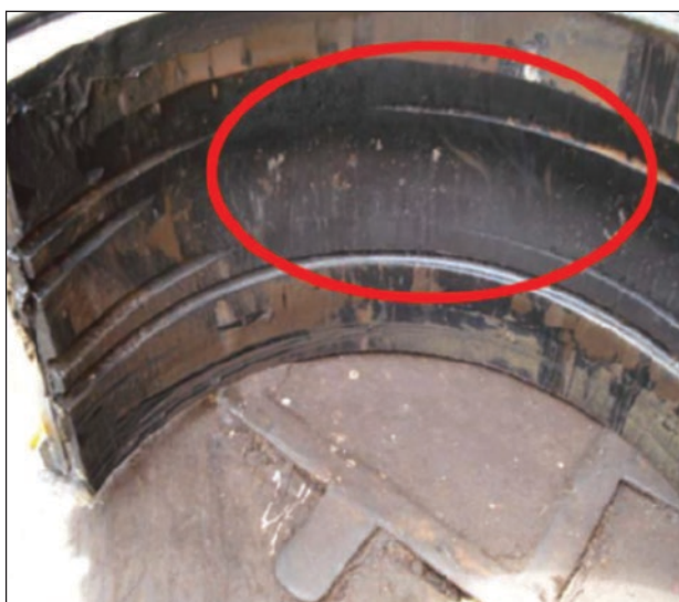
Slika 9. Nejednoliko potrošen brtveni element teleskopske spojnice (Upton, 2009)
