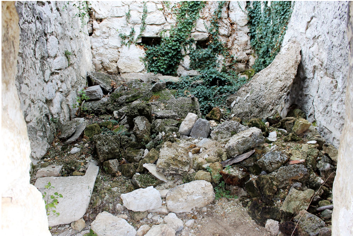
SLIKA 5. Zatečeno stanje crkve – unutrašnjost (foto: S. Bekavac; © DisKont)
