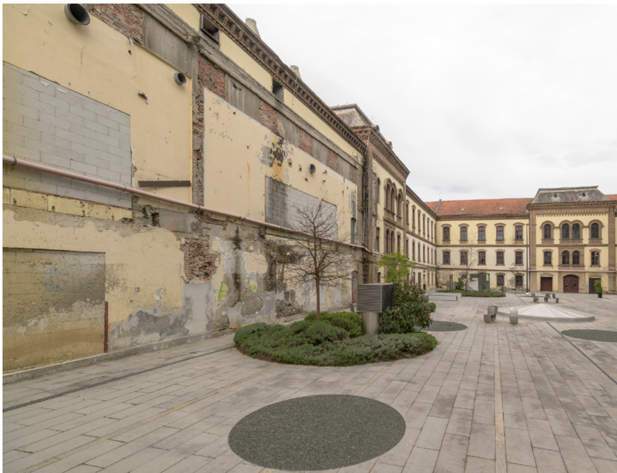
20. Dvorišna pročelja, stanje nakon potresa (snimka: Lj. Gamulin, HRZ, 2021.) Courtyard façade after the earthquake (Lj. Gamulin, HRZ, 2021)
