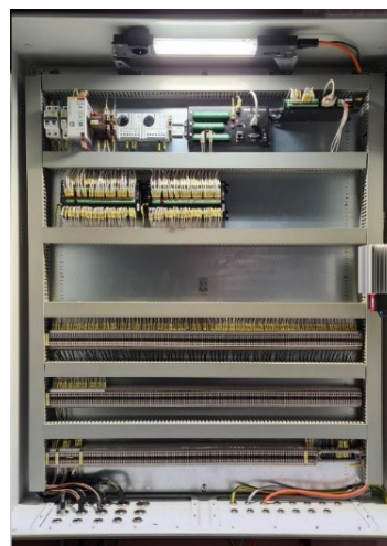
Slika 9 Prikaz opreme u elektro upravljačkom ormaru
