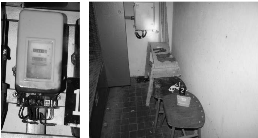
Slike 6 i 7: Električno brojilo s tragovima oštećenja, električarski alat i poklopac brojila
