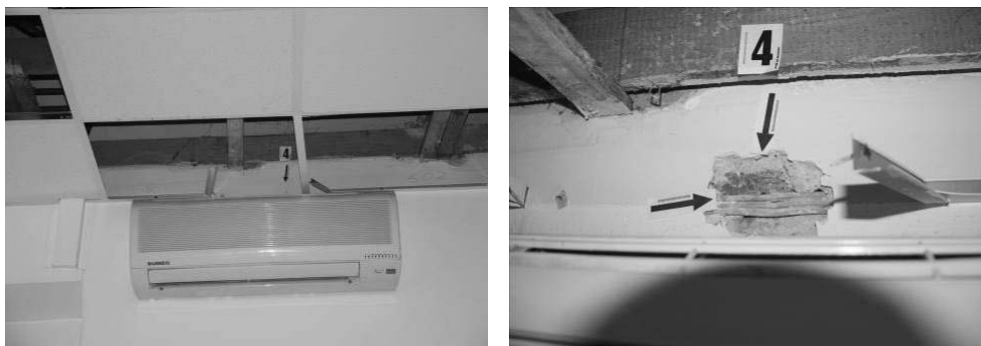
Slike 4 i 5: Mjesto kvara i oštećenje na električnoj instalaciji
