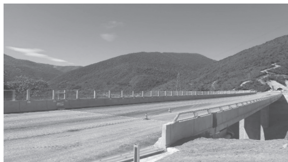
Slika 1. Zidovi za zaštitu od buke na vijaduktu Jelovik, na Corridoru Vc
