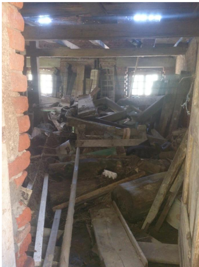
Lipik - Dio interijera kuće kroz koju je prošao vodni val; upozorenja i na oštećene instalacije struje po uključivanju u mrežu
