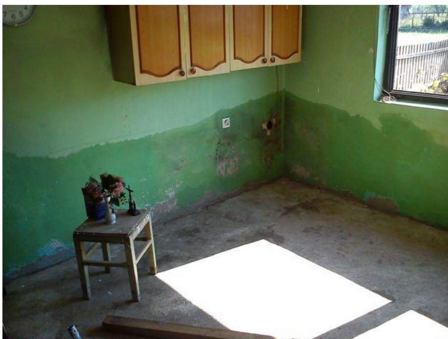
Poplavljena kuća u mjestu Gradac
