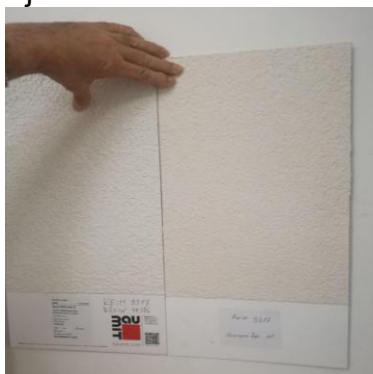
Slika 6: Odstupanje boje fasade.
