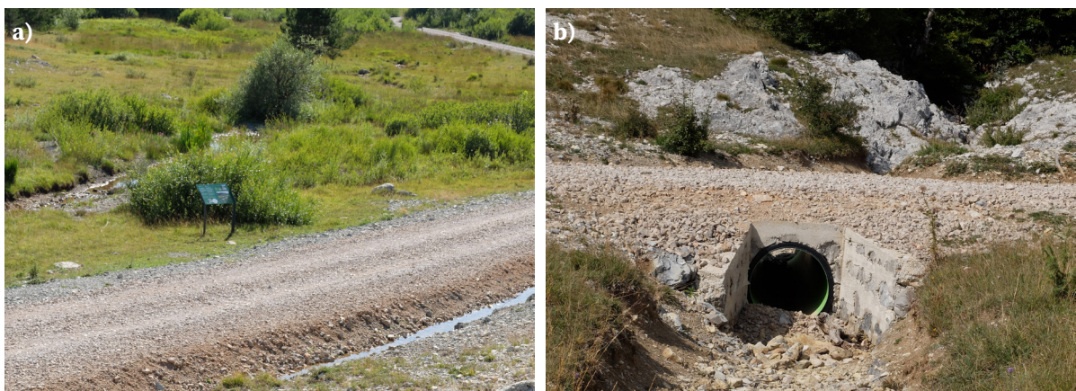
Slika 5. Odvodni kanal sa sjeverne strane šumske ceste uz cret Ljubicu danas odvodi vodu koja se nekada slijevala preko ceste dodatno natapajući cret (a); propusti ispod šumske ceste uz potok Ljubicu dodatno ubrzavaju otjecanje vode (b).
