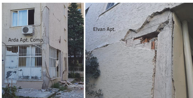
Slika 29. Dijagonalne pukotine na nosivim i nenosivim elementima
