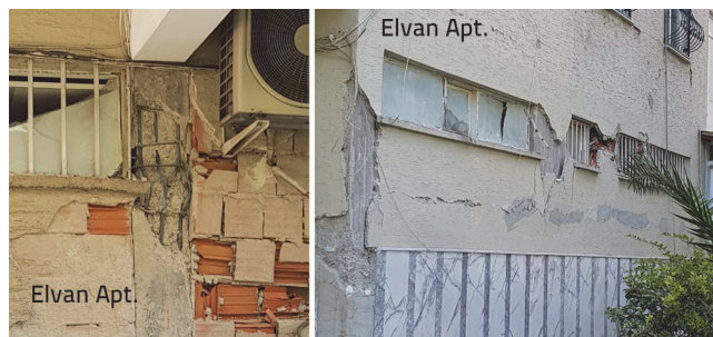
Slika 39. Kratki stup teško oštećene zgrade
