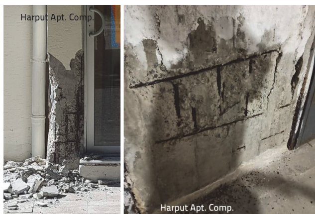
Slika 35. Korozija armature uslijed vlage
