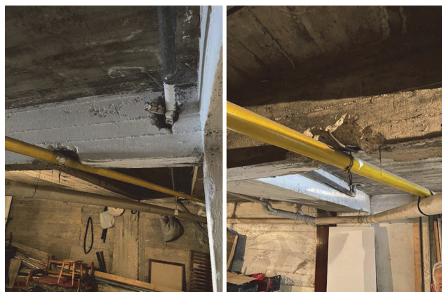
Slika 40. Greda oštećena prilikom ugradnje vodovoda (Karşıyaka, Izmir)
