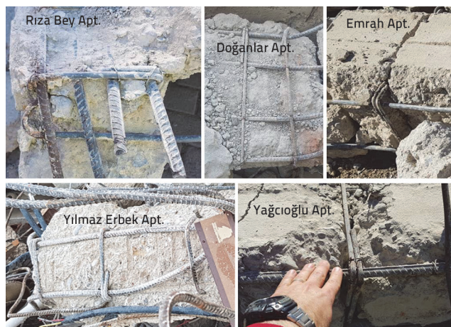
Slika 37. Krajevi stremena (savijeni za 90°) urušenih zgrada
