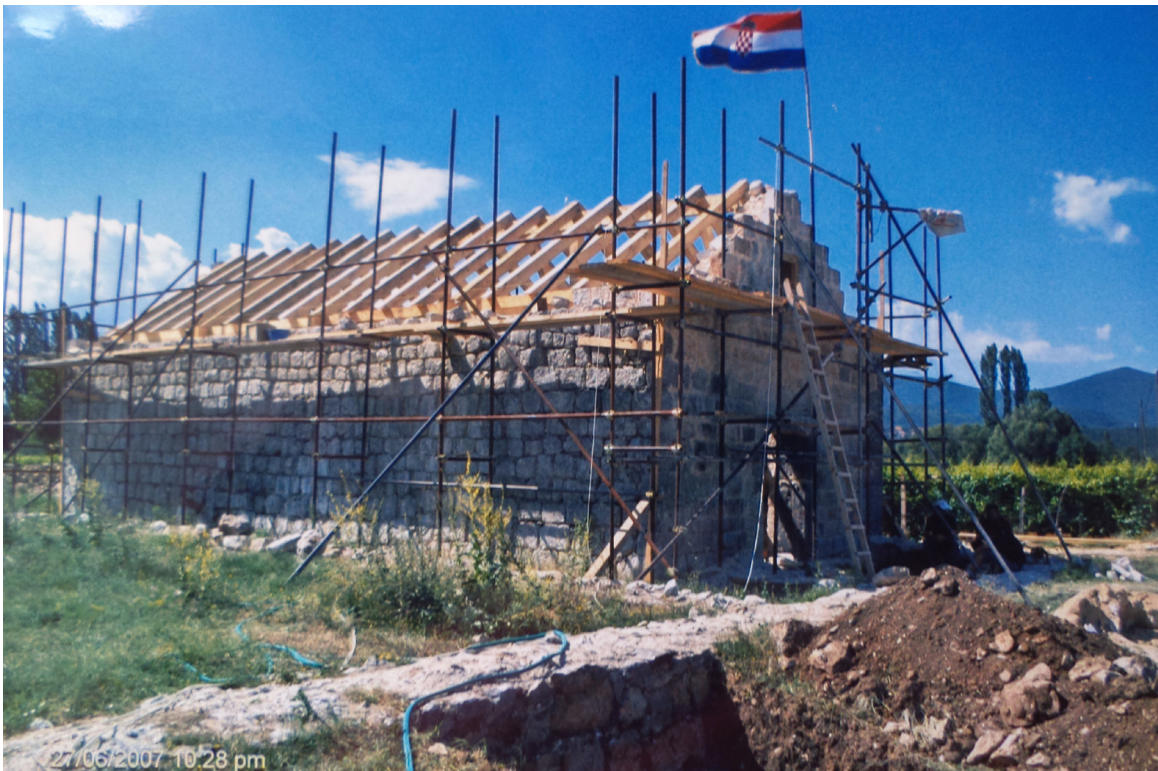
Sl. 18. Postavljanje krova na kapelici Blažene Djevice Marije od Ružarija (foto: S. Tonković) Fig. 18 Mounting of the roof on the chapel of the Blessed Virgin Mary of the Rosary (photo: S. Tonković)
