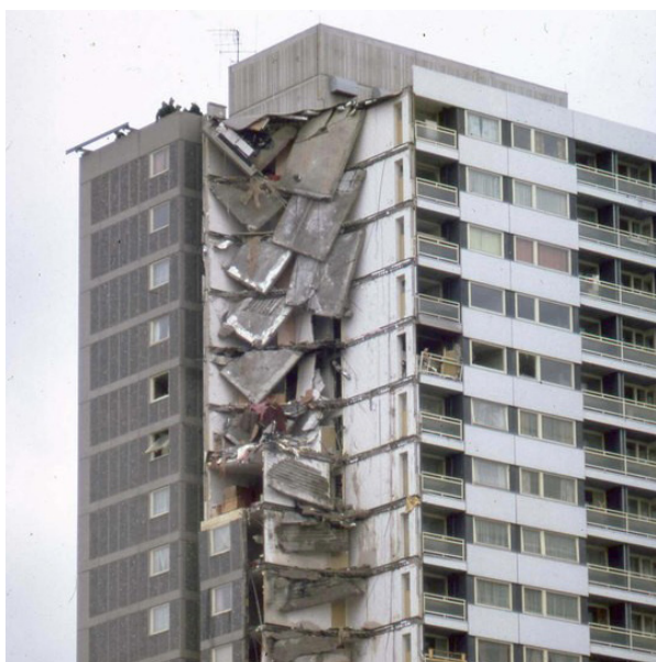
Slika 1 Urušavanje zgrade Ronan Point
