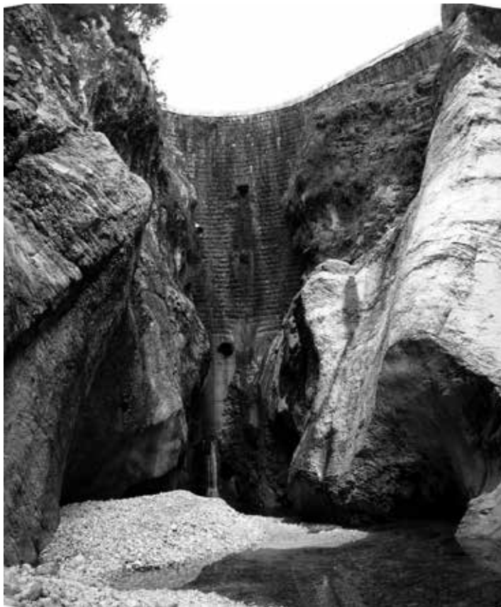
Foto diga di Crosis, realizzata tra il 1900 e il 1902 dall'Impresa edile Rizani Spa per conto del Malignano, in Comune di Tarcento, (UD).
